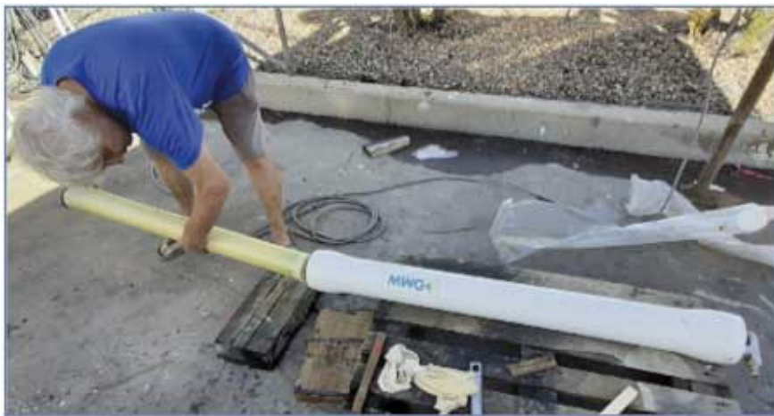
Tutti gli impianti di Obiwan sono stati passati in rassegna e ripristinati; tra questi c'è anche il dissalatore al quale sono stati sostituiti membrana e filtri.
